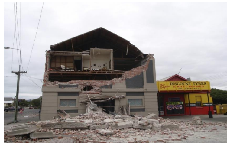
Loša povezanost zida gornje etaže, Christchurch, New Zealand, februar 2011.
