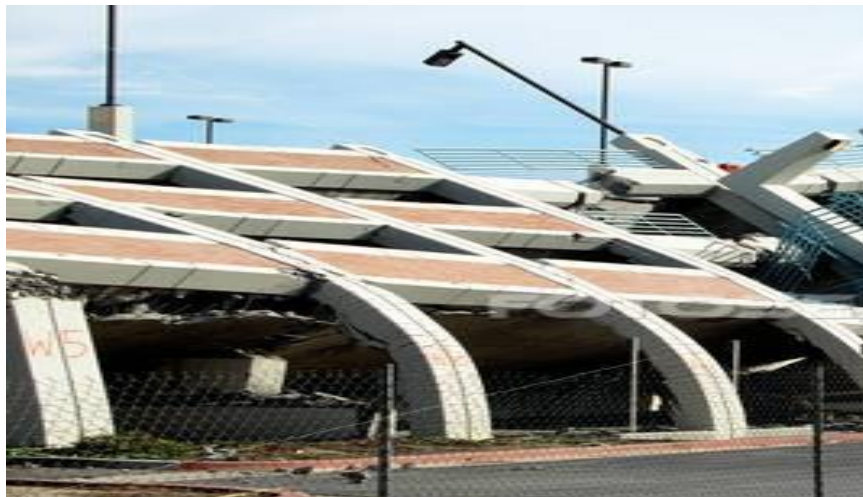
Loše odabran konstruktivni sistem, zemljotres Northridge, Los Angeles, 1994, skeletna konstrukcija, opeka ispuna
